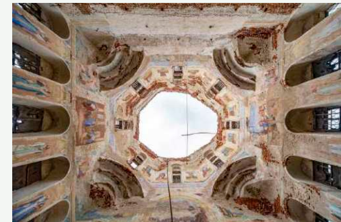
Il crollo del tetto al di sopra dell'ottagono.
